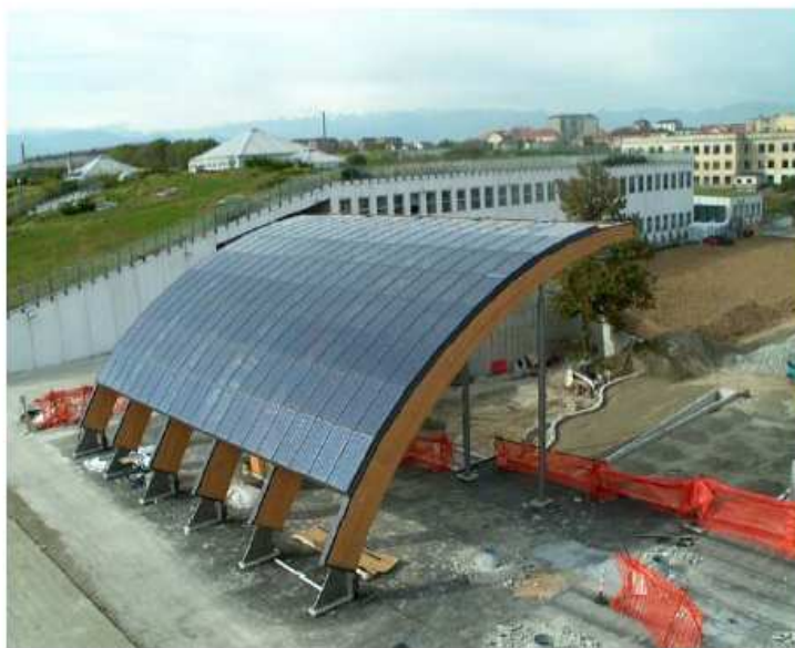
Fig. 1 Il "Totem Fotovoltaico", vista aerea
