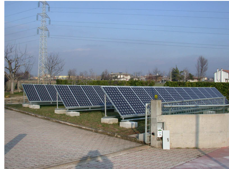
IMPIANTO NON INTEGRATO 5.5 kW
