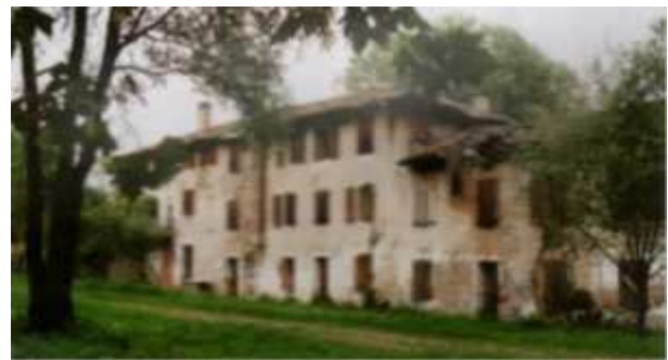
Condizioni in cui versava l'edificio nel 1995
