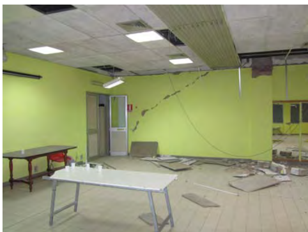
Danni alle tramezzature ed al controsoffitto
