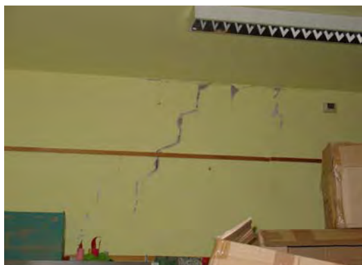
Danni alle tramezzature
