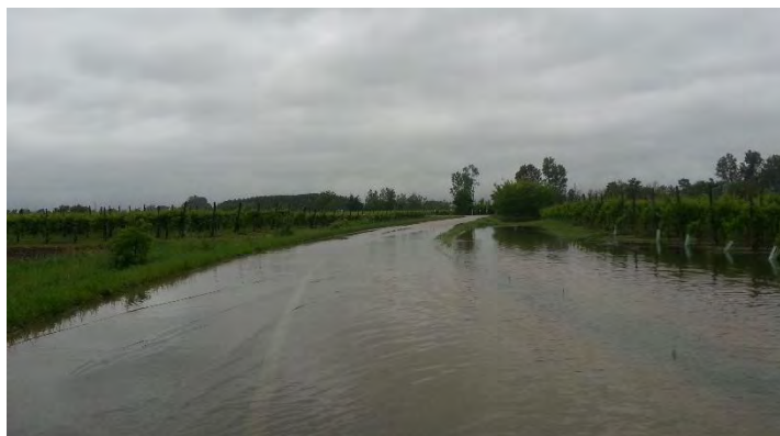
Allagamento della sede viaria prima dell'intervento
