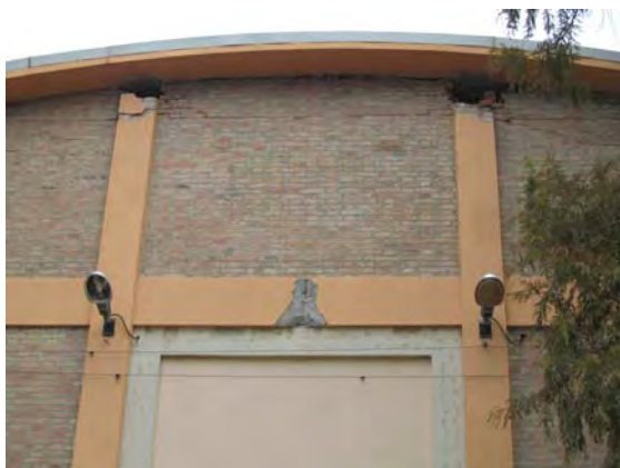
Danni agli elementi strutturali di copertura
