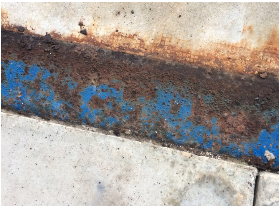
Figura 5 – Azione di corrosione su elemento del telaio in acciaio
